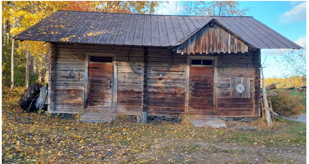
Jälkiä asuinrakennukseen linnoittautuneiden vihollisten ampumista luodeista Putaalan Aitan seinässä. Kuvat: AK
